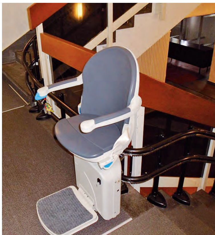
Im Treppenhaus des Guthofes kann nun statt der Treppen auch ein Lift genutzt werden, um den Karchersaal zu erreichen. Foto: Stadt Neunkirchen
